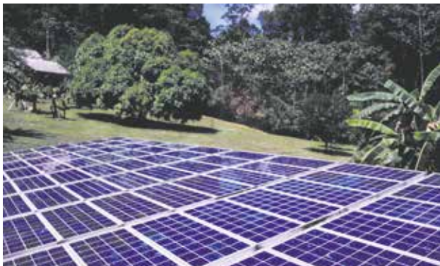
Panneaux solaires alimentant en électricité un village dans une réserve naturelle en Guyane.
