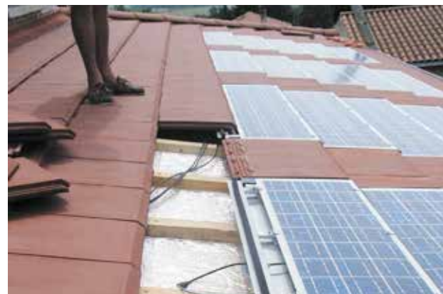
Intégration en toiture de tuiles photovoltaïques.
